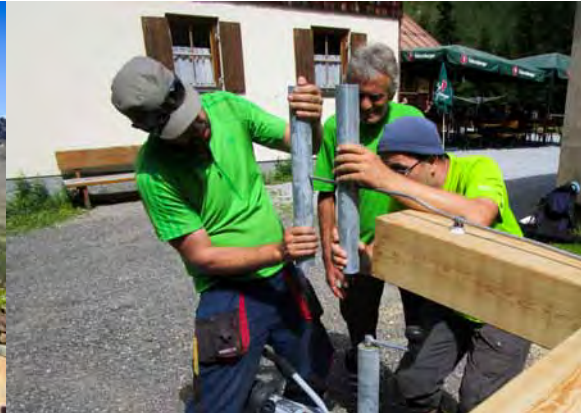
Auch ein Blitzschutz ist von Nöten.
